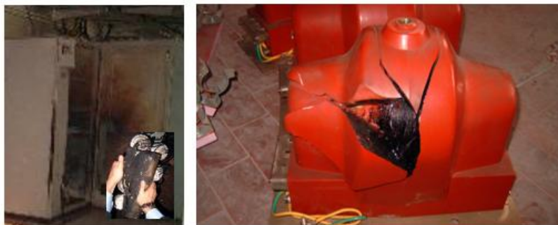
Fig. 7.2.8 – esempi di guasti causati dalle risonanze pericolose
